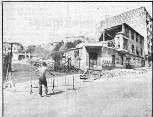
Demolición de Mármoles Cantabria. La antigua fábrica de Mármoles Cantabria, en Eguía, está siendo demolida tras acuerdo adoptado por la Corporación donostiarra. En el solar que queda vacío al término de las obras se instalará un aparcamiento en superficie. El parking tendrá carácter temporal, ya que el uso definitivo del terreno se estipulará tras la revisión del plan parcial de la zona. En la fotografía, aspecto que presentaban ayer los trabajos de demolición. (Foto Agyúés)
