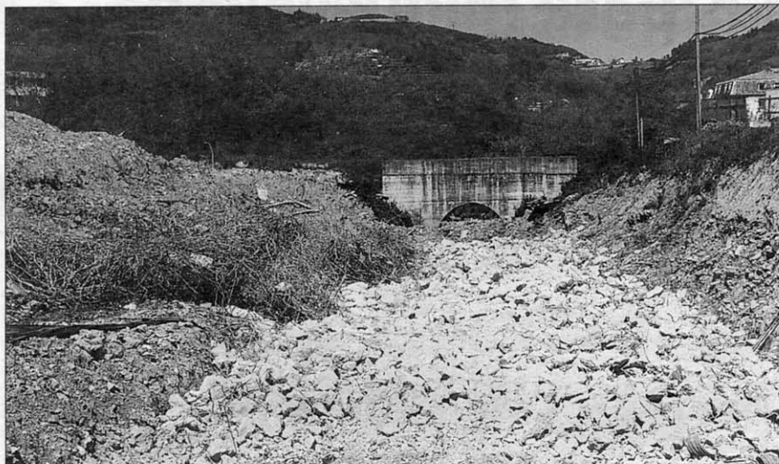
En la obra del MOPT, un error de nivelación ha obligado a romper parte de lo realizado. POSTIGO
