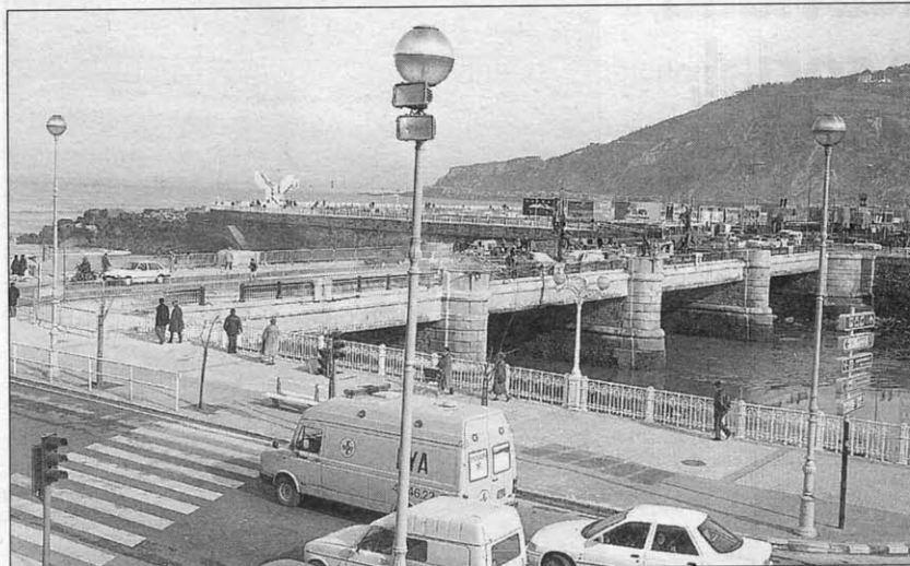
El puente del Kursaal, durante la obra de restauración, que resultó problemática y costosa. MICHELENA
